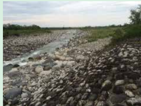
常願寺川に設置された巨石付き盛土砂州(流路線形の是正と河岸防護に効果大)
